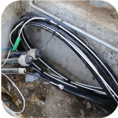
Réseau de fibre optique
