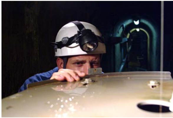
Relevé de mesures sur un pendule dans la galerie d'un barrage hydraulique
